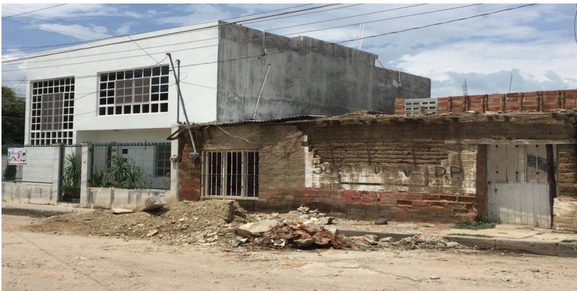
Romero Morales, Daniela. (17 de julio 2018). Viviendas afectadas. [fotografía]. México: Chiapas.
