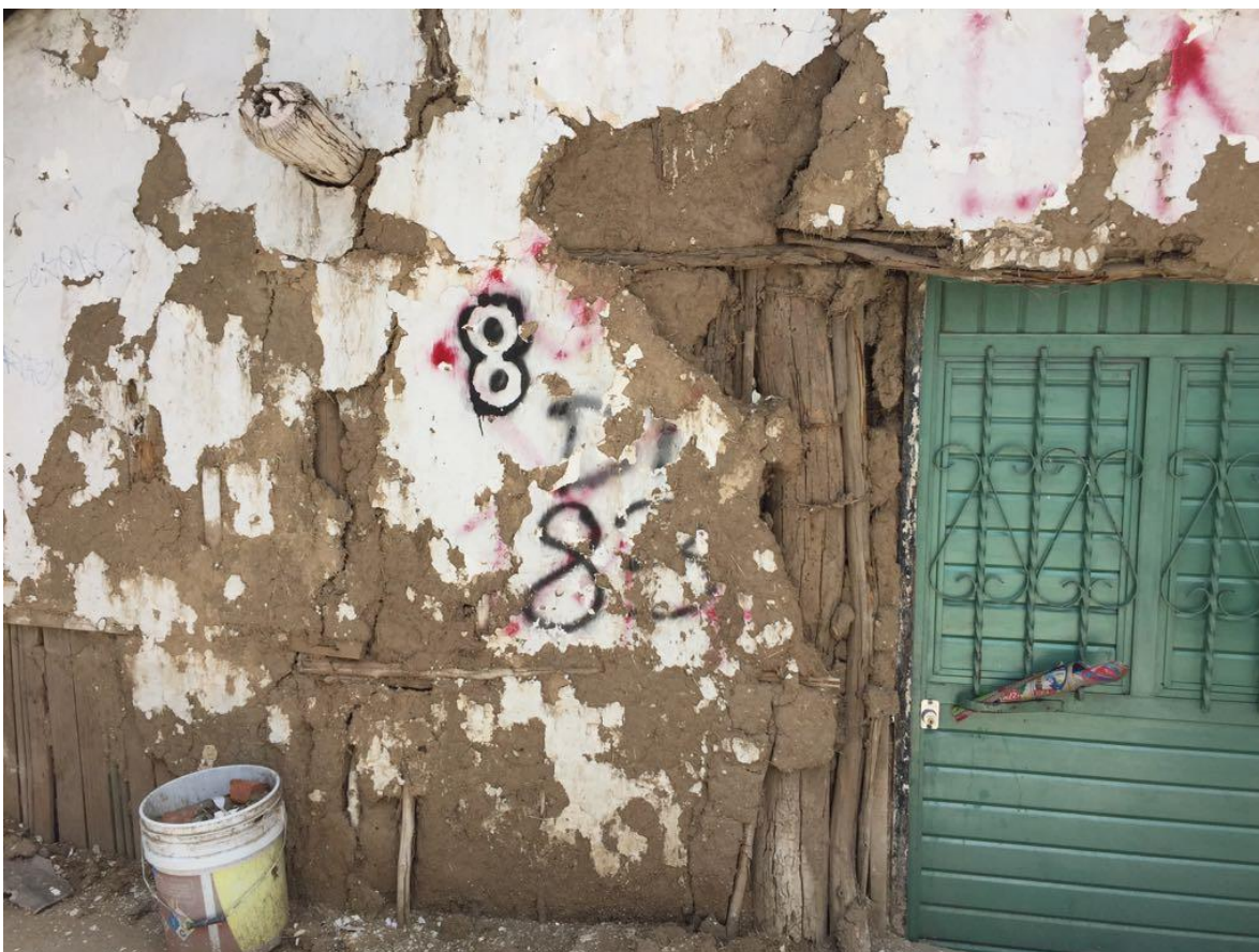
Romero Morales, Daniela. (24 de julio 2018). Viviendas afectadas. [fotografía]. México: Chiapas.
